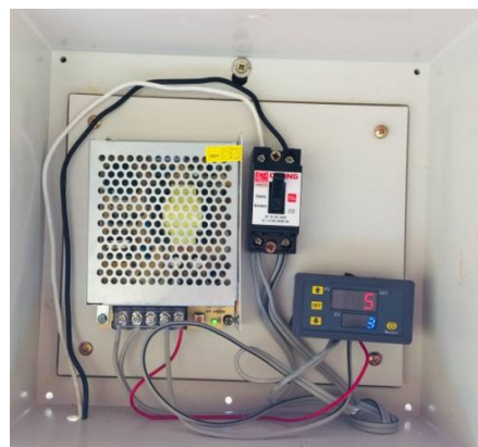
ภาพที่ 3 อุปกรณ์จ่ายไฟกระแสตรงพร้อมอุปกรณ์ตั้งเวลาทำงาน
