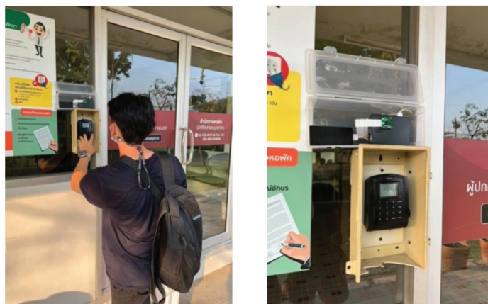
ภาพที่ 8 แสดงรูปแบบการติดตั้งอุปกรณ์ในการทดลองใช้งาน - การใช้งานในหอพัก
