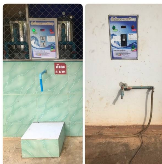
รูปที่ 3 ตู้น้ำดื่มหยอดเหรียญอัตโนมัติประเภทมีหัวบรรจุติดตั้งอยู่ที่ผนังภายนอกอาคาร รูปแบบที่มีการต่อท่อยื่นออกมา จากตัวอาคารสำหรับจ่ายน้ำ
