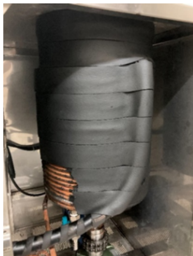
(ก) ถังไอศกรีมติดตั้งฉนวน
