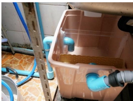
ภาพที่ 5 ท่อระบายน้ำทิ้ง
