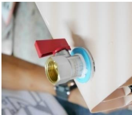
ภาพที่ 6 วาล์วเปิดตะกอนไขมันทิ้ง
