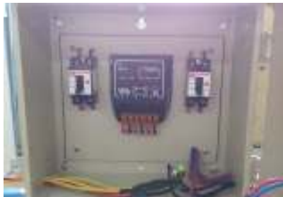
ภาพที่ 5 วงจรควบคุมการชาร์จประจุไฟฟ้าเข้ากับ แบตเตอรี่ Deep Cycle
