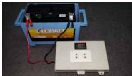
ภาพที่ 6 การต่อแบตเตอรี่ Deep Cycle เข้ากับ อินเวอร์เตอร์ (Inverter)
