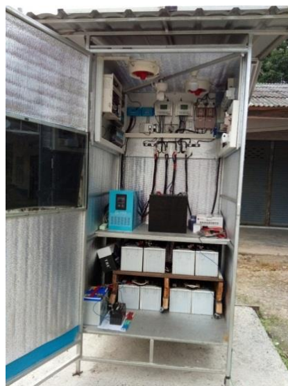
ภาพที่ 8 ลักษณะภายในโรงไฟฟ้าสมาร์ทไฮบริด
