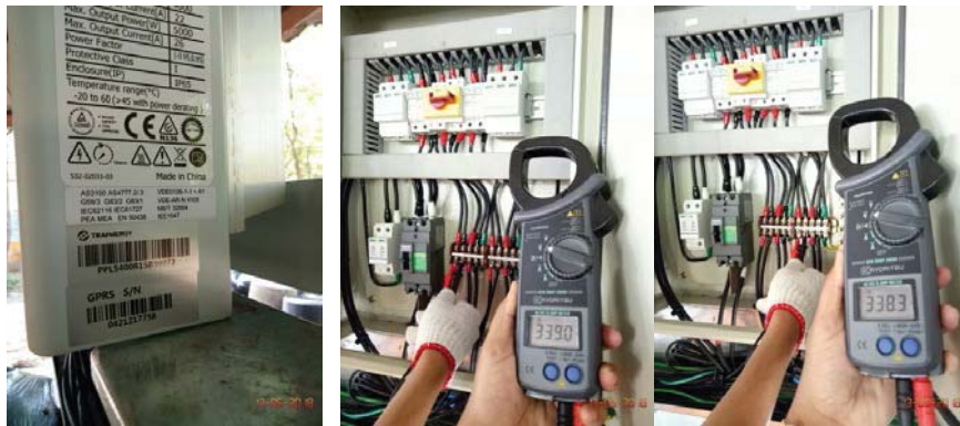
ภาพที่ 6 (ก) Inverter ขนาด 5.0 kW และ (ข) ค่า Vdc ของแผงเซลล์แสงอาทิตย์ (> 80% ของการออกแบบ)
