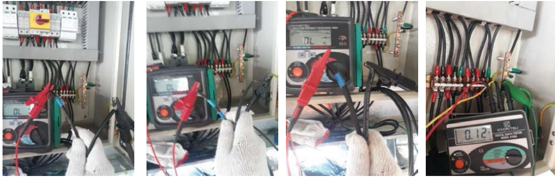
ภาพที่ 5 (ก) สายไฟ DC (Group 1) วัดสาย + , วัดที่ 1,000 Vdc ได้ค่า OL M \Omega (ข) สายไฟ DC (Group 2) วัดสาย + , - วัดที่ 1,000 Vdc ได้ค่า OL M \Omega (ค) สายไฟ AC วัดสาย + , - วัดที่ 500 Vdc ได้ค่า OL M \Omega และ (ง) หลักดินตู้ DB วัดค่าได้ 0.12 \Omega (ค่าต้องไม่มากกว่า 5 \Omega )
