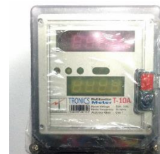
รูปที่ 10 มิเตอร์ไฟฟ้าดิจิทัล
