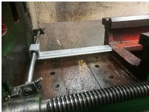
รูปที่ 16 ร่องแท่นกลึงหลักติดตั้งอุปกรณ์กำจัดเศษงานกลึงหน้าแท่นกลึง
