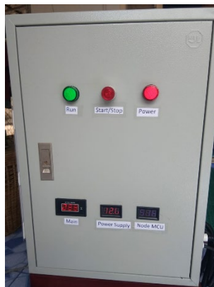
รูปที่ 4 ด้านหน้าตู้ควบคุม
