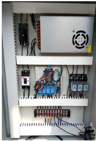
รูปที่ 3 ระบบควบคุมที่ต่อวงจรเรียบร้อยแล้ว
