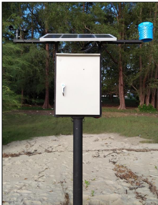
ภาพที่ 15 ลักษณะตู้ควบคุมของระบบ
