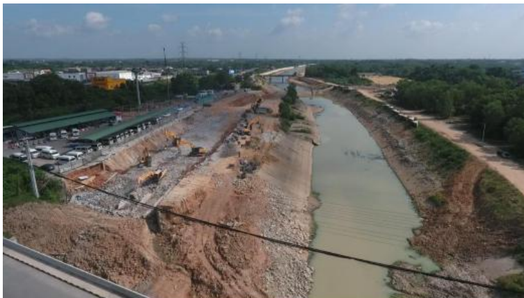
ภาพที่ 2 สภาพการทรุดตัวของดินบริเวณโครงการบรรเทาอุทกภัยอำเภอหาดใหญ่ (ระยะที่ 2) จังหวัดสงขลา
