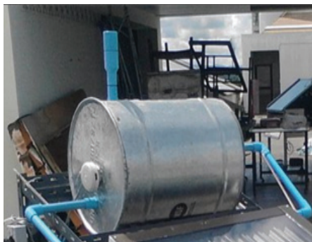
ภาพที่ 5 ถังเก็บน้ำร้อน
